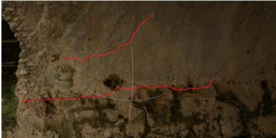
Figura 2. Esempio di fessura evidenziata sul modello 3D acquisito mediante tecnica di fotogrammetria Structure From Motion.
